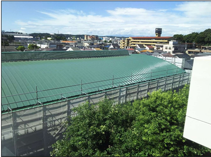
No.4 調布市立富士見台小学校体育館改修工事 屋根塗装工事 施工完了
