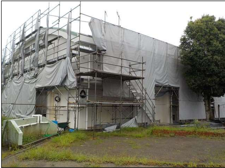
No.1 調布市立飛田給小学校体育館 屋根及び外壁改修工事 外壁改修 施工状況
