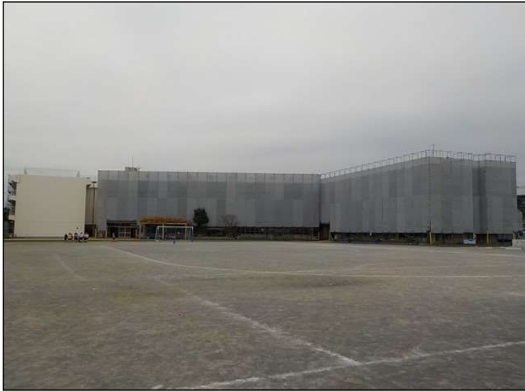
No.1 調布市立布田小学校校舎外壁改修工事 外壁改修 施工状況
