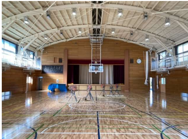
No.5 調布市立富士見台小学校体育館改修工事 体育館内部 施工状況
