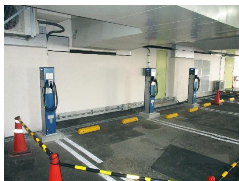
導入した充電ステーション（管財課）
