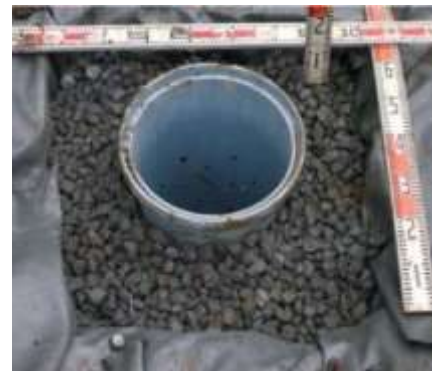
宅地内 雨水浸透ます
