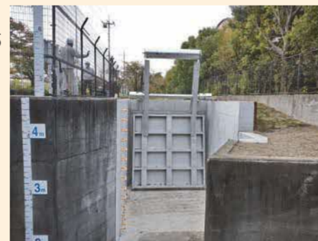
根川第1雨水幹線への逆流防止ゲート
