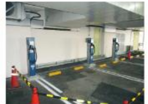
導入した充電ステーション（管財課）
