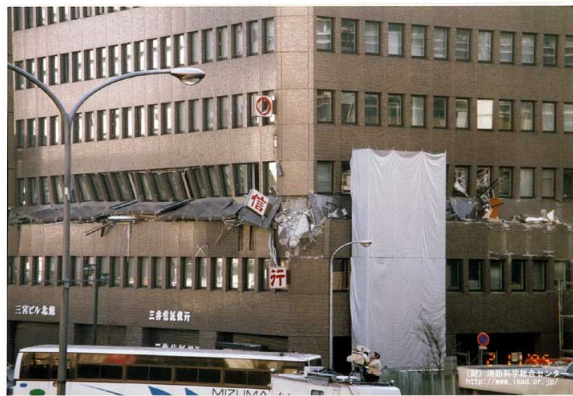
(d) ビルの損壊
